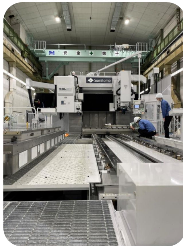
現在導入中の生産設備
